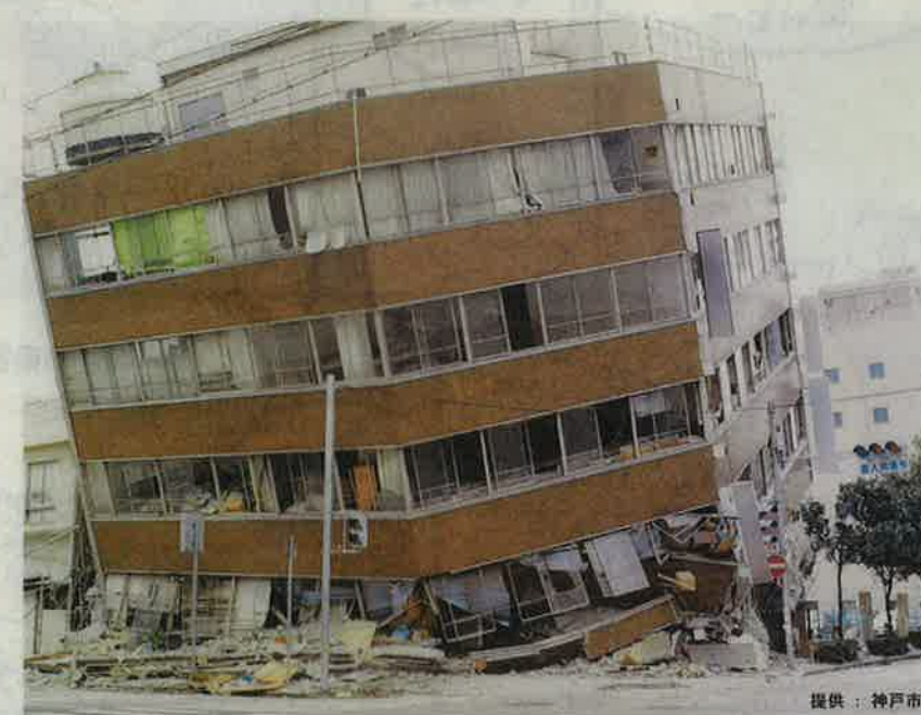
阪神・淡路大震災で傾いてしまったビル(1995年)
